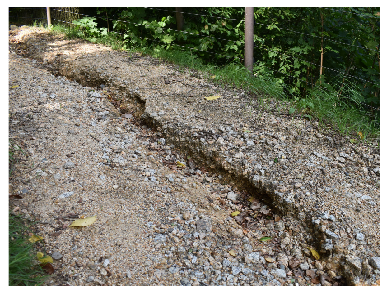
Ausspülung der Wege durch Starkregen im Sommer 2024. (Foto: J. Salomo)
